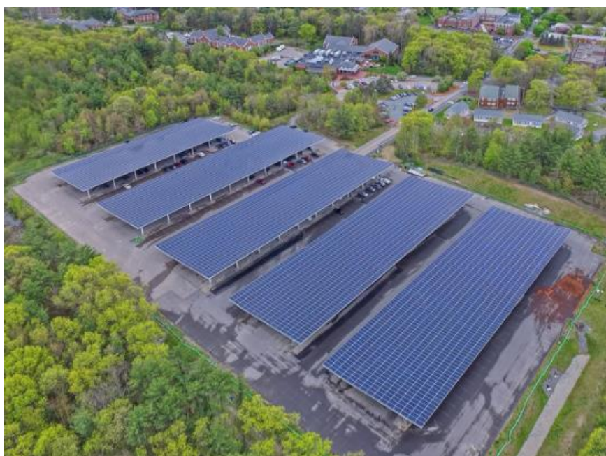
Obr. 2-28 Fotovoltaické parkoviště vysoké školy Stonehill College [52]
