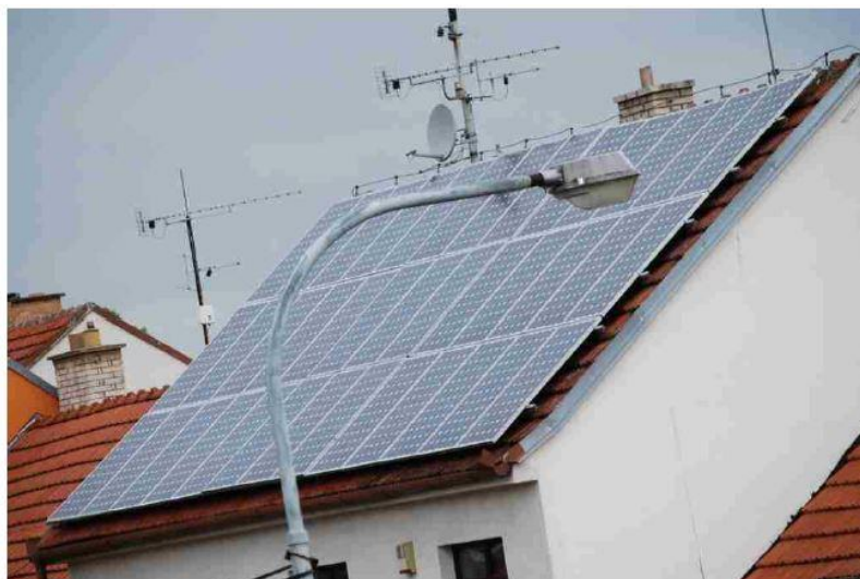
Obr. 8-3 Fotovoltaická instalace ve Střelicích [44]
