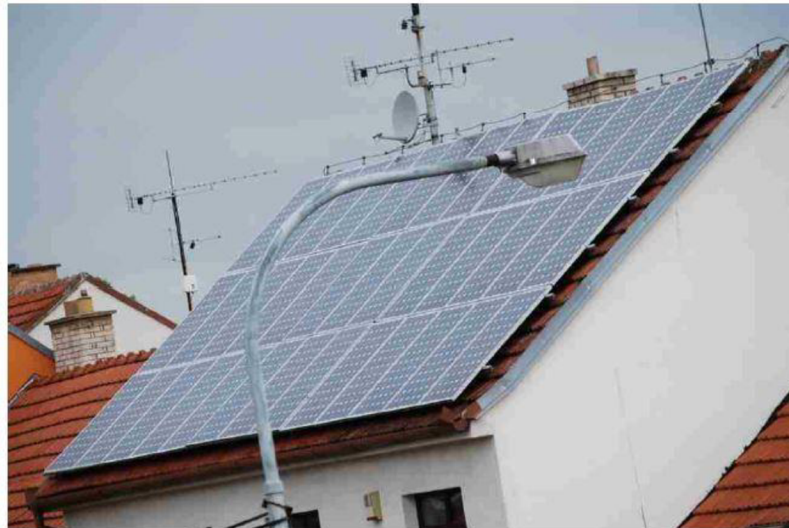
Obr. 8-3 Fotovoltaická instalace ve Střelicích [44]
