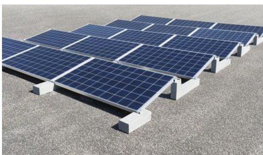
Obr. 2-19 Fotovoltaické moduly zatíženy betonovými kvádry [17]
