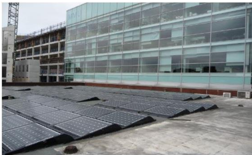
Obr. 8-2 Část fotovoltaické instalace na střeše budovy John Dalton tower block v Manchesteru [45]
