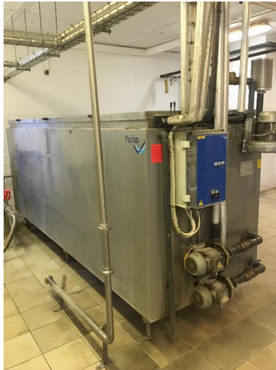
obr. 13 Nádrž na ledovou vodu na chlazení mléka
