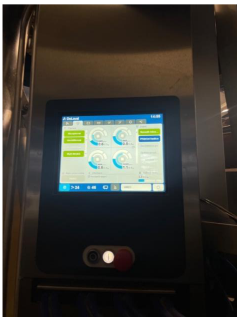
obr. P. 4 Řídící jednotka u RD DeLaval
