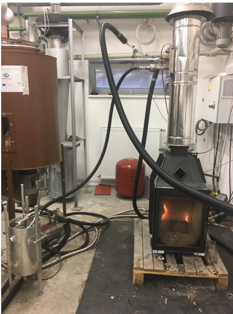
Obrázek 18: Měřicí zařízení, krbová vložka, sběrné zařízení a výměník (vlevo)
