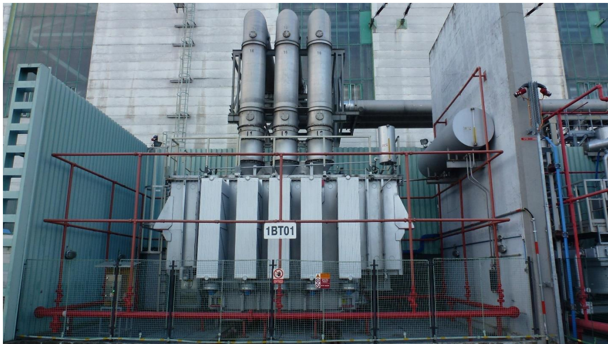
Obr. 3-5 Odbočkový transformátor 1BT01 na Jaderné elektrárně Dukovany [5]
