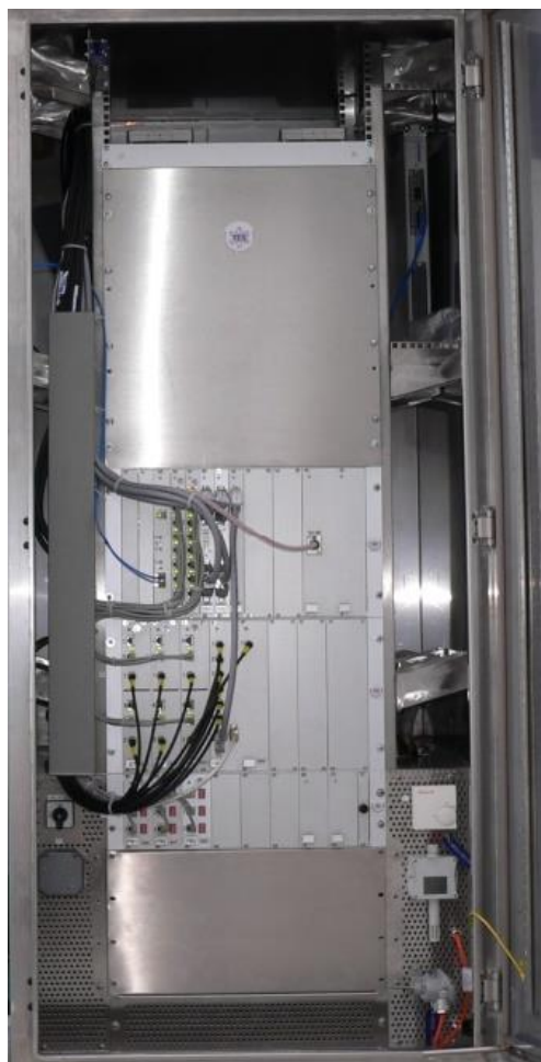
Obr. 4-5 Hlavní instrumentace skříně MT02 [5]
