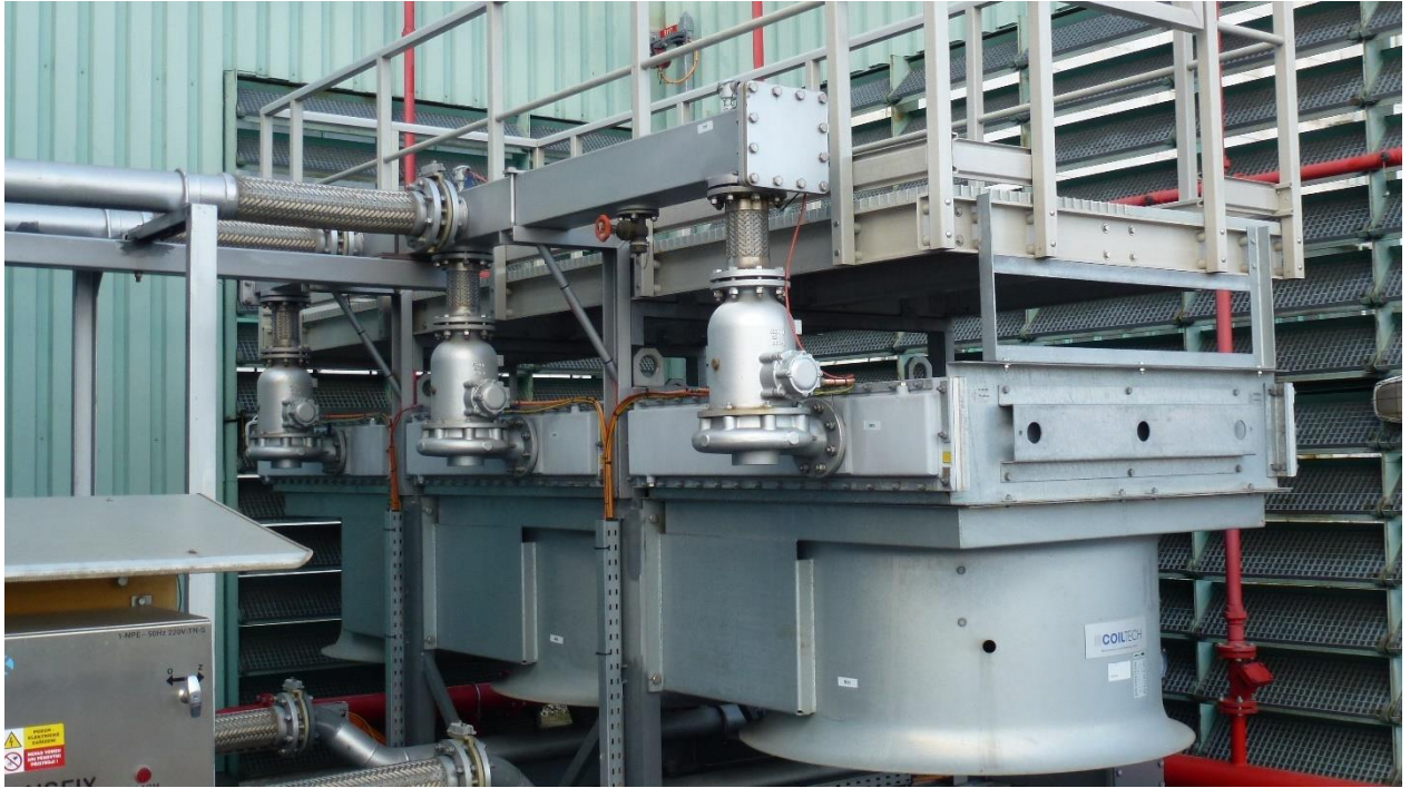
Obr. 3-3 Chladicí sekce 1AT01-RM1 blokového transformátoru [5]
