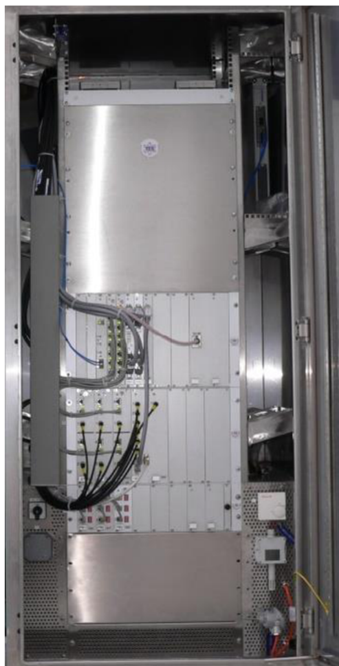
Obr. 4-5 Hlavní instrumentace skříně MT02 [5]
