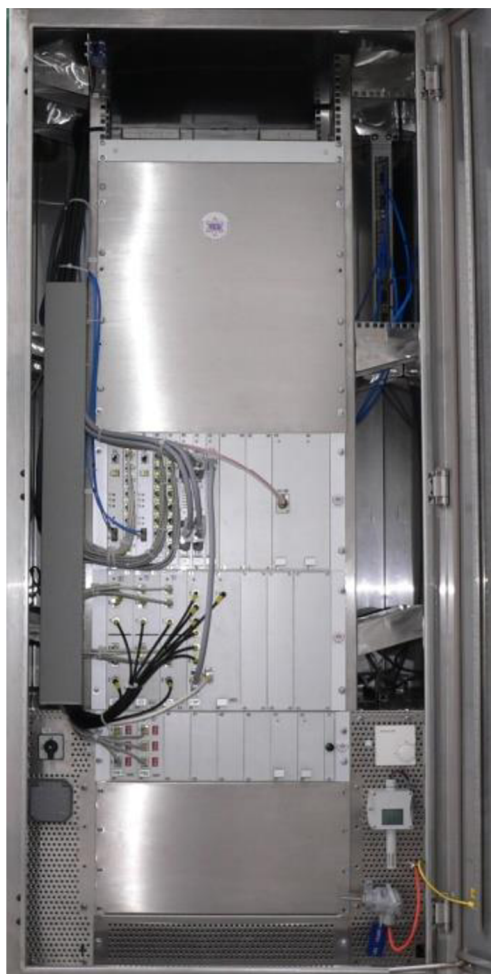
Obr. 4-4 Hlavní instrumentace skříně MT01 [5]
