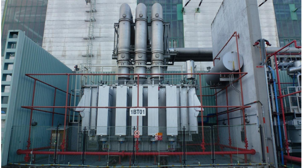
Obr. 3-5 Odbočkový transformátor 1BT01 na Jaderné elektrárně Dukovany [5]
