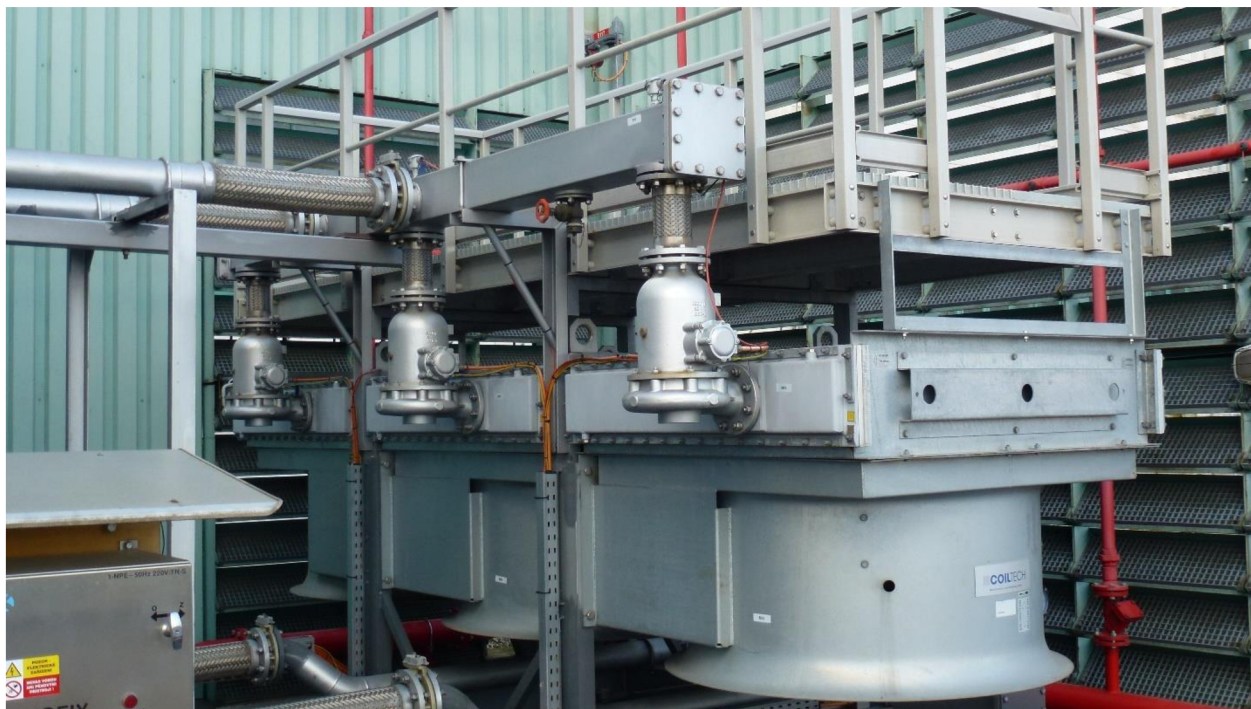
Obr. 3-3 Chladicí sekce 1AT01-RM1 blokového transformátoru [5]
