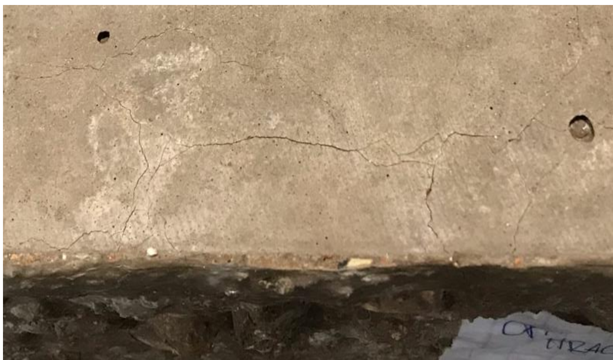
Obrázek 3: Porušené těleso betonu CP po 50 cyklech
