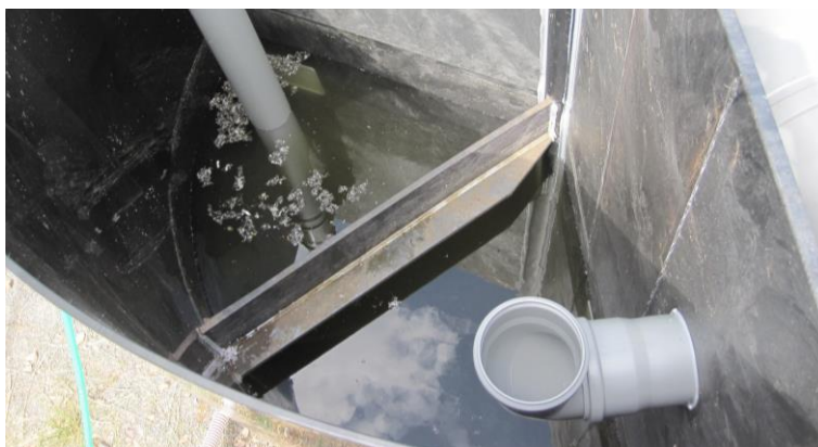
Obr. 38 Detail kolene potrubí DN 110 ve druhé komoře septiku
