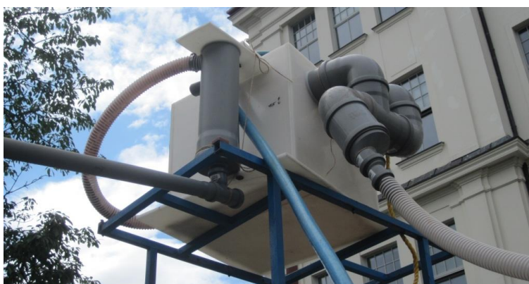
Obr. 19 Horizontálně umístěné potrubí pro regulaci průtoku (vlevo)
