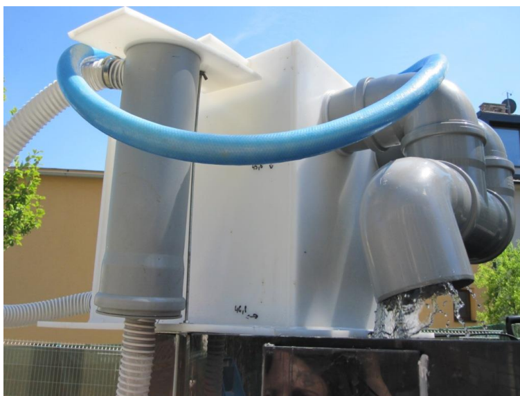
Obr. 35 Odtokové potrubí na regulačním přelivu
