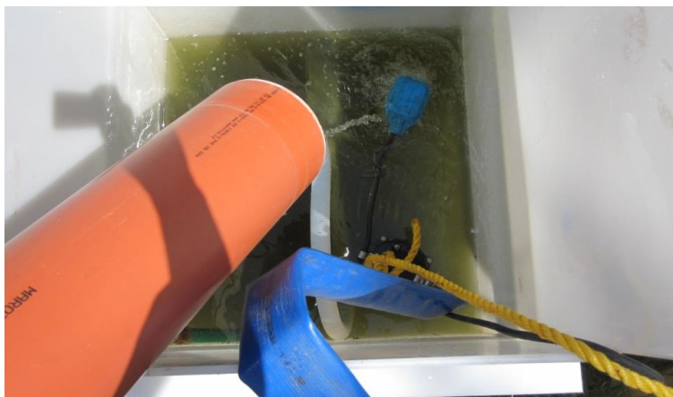
Obr. 33 Čerpadlo s plovákem umístěné v šachtě na odtoku z tří komorového septiku
