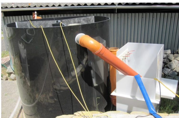
Obr. 32 Sběrná šachta vody odtékající ze septiku
