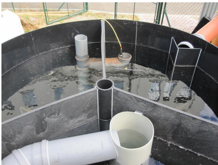
Obr. 40 Původní umístění červené sondy do kolene potrubí DN 110 v první komoře
