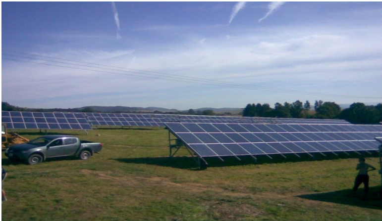
Obrázek 2 Jižní pohled na FVE Pv-park
