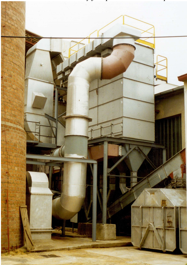
Obr. 8.2 OFF-LINE látkový filtr před uvedením do provozu. [24]
