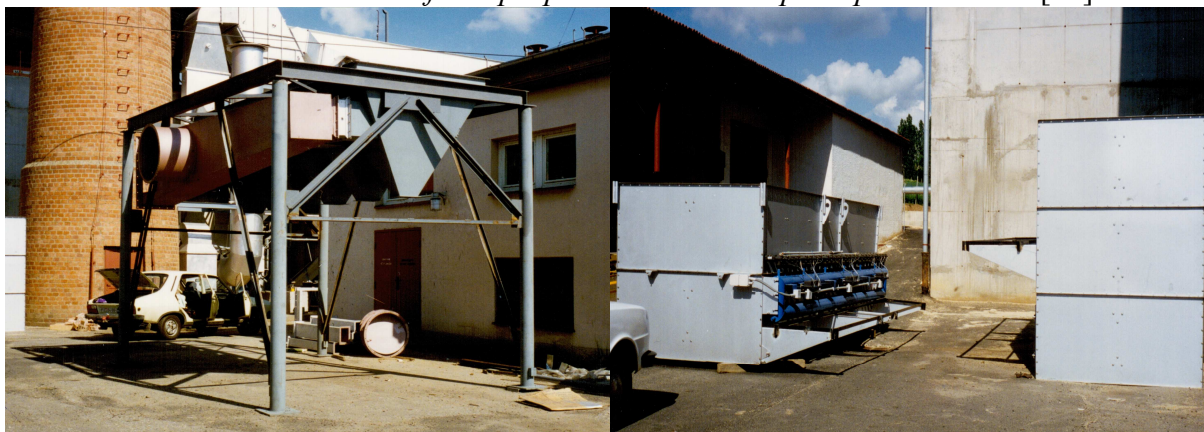
Obr. 8.1 Části OFF-LINE filtru při přestavbě čištění spalin před montáží. [24]
