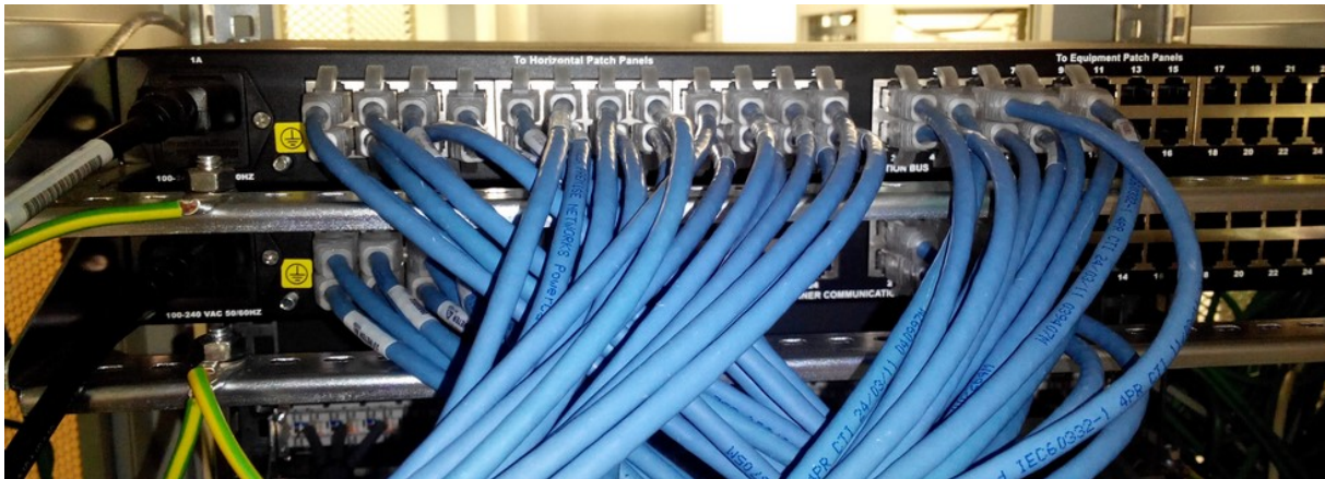
Obrázek 11 - dva MIIM scannery obsluhující jednu technologickou místnost - připojení panelů (zdroj: autor)
