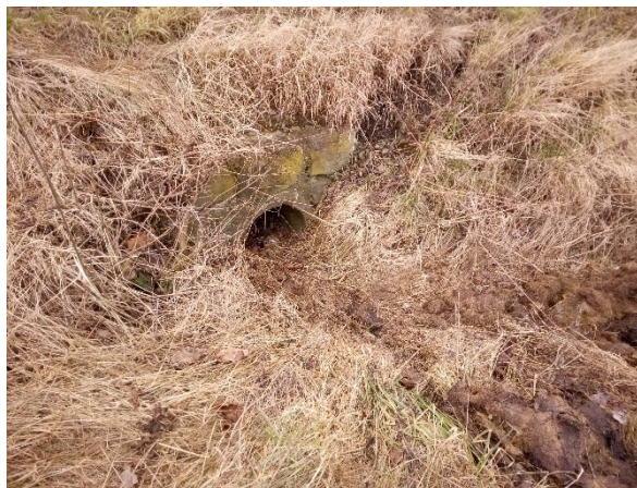
Obr. 47 Vtok do propustku ze záchytného příkopu v KB 3 (Poruba, foto M. Majkus, II. 2020)
