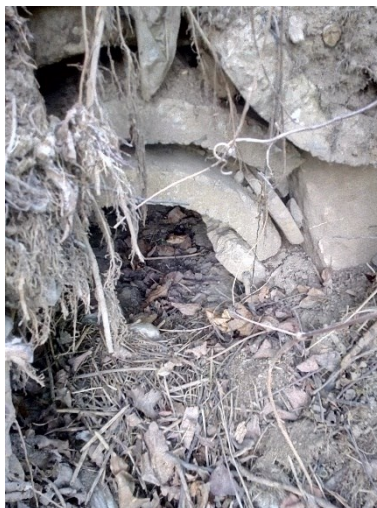
Obr. 35 Výstř propustku KP 5 do Loučského potoka (Hustopeče n./B., foto M. Majkus, IV. 2020)
