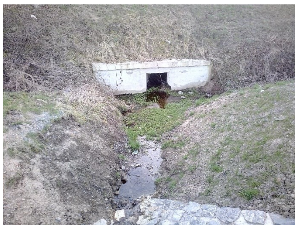
Obr. 39 Záchytný příkop a propustek pod silnicí I/35 E442 v KP 6 (Hustopeče n./B., foto M. Majkus, III. 2020)
