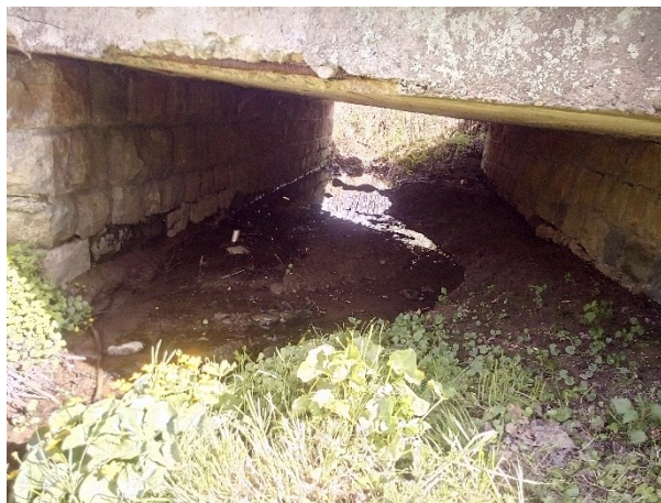
Obr. 61 Mostek těsně pod KB 5 (Poruba, foto M. Majkus, IV. 2020)
