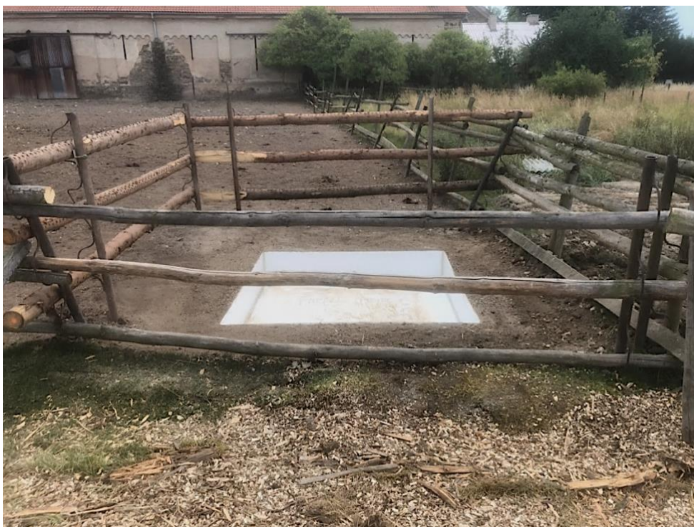
Obrázek 10: Instalace vaničky u výběhu krav Českých červinek na Středisku živočišné výroby Amálie 2023 (foto Ing. Luboš Bárta).
