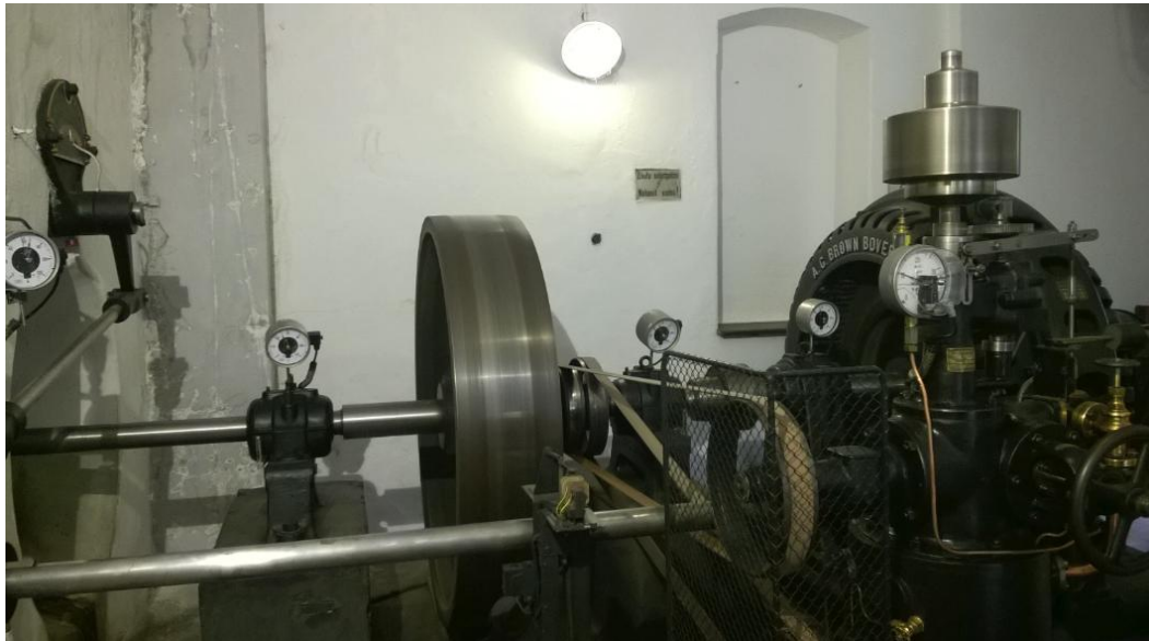
Obr. č. 26 Strojovna elektrárny Čeňkova pila
