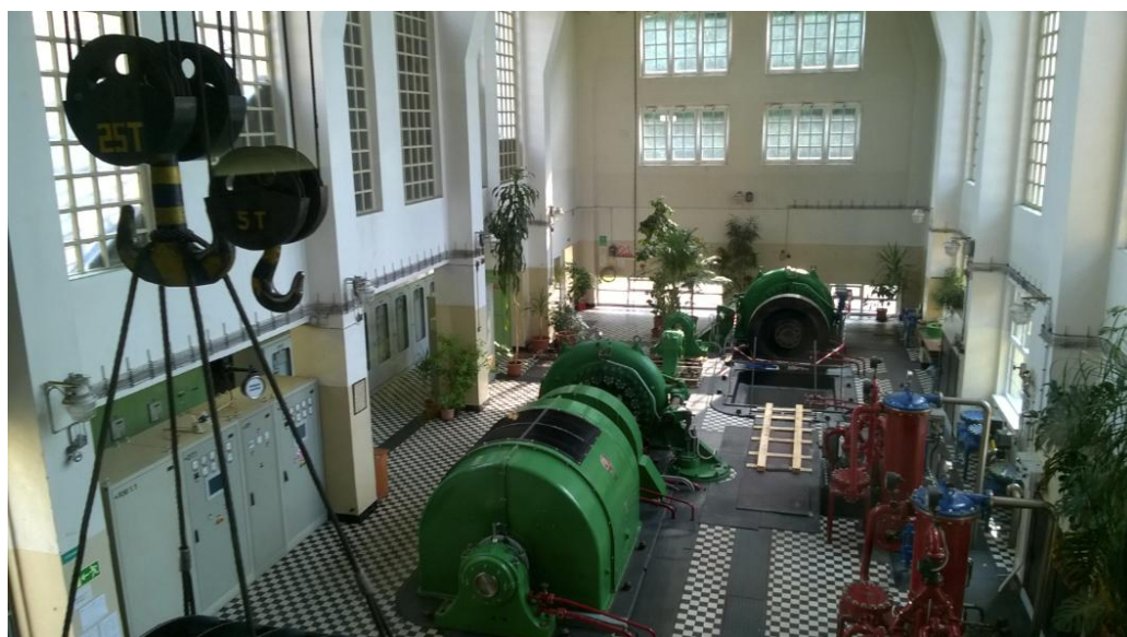
Obr. č. 23 Pohled do strojovny elektrárny Vydra
