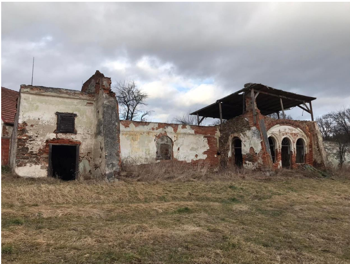
Obr. č. 75 Současný stav oranžerie. Všechny skleněné plochy zmizeli a stavbu kryje pouze provizorní zastřešení.
