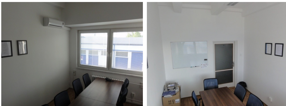
Obr. 8.1 Fotografie zasedací místnosti s instalovanou chladicí jednotkou Sinclair
