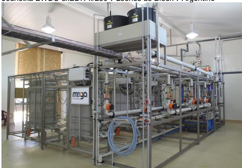
Jednotka EWDU 6xEDR-II/250 v Leones de Bleek v Argentíně
