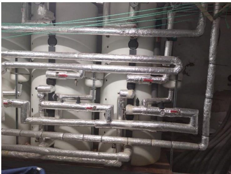
Obrázek 2 - Kondenzační nádrže tepelného čerpadla v hotelu Imperial
