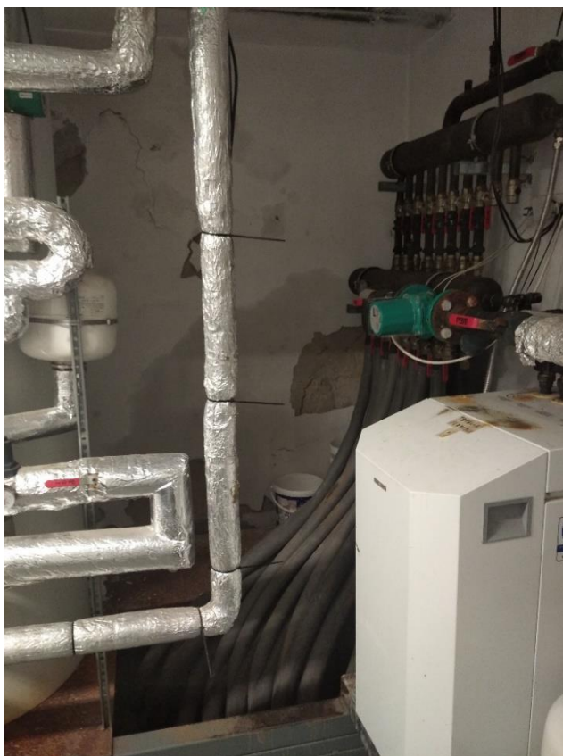
Obrázek 3 - Tepelné čerpadlo v hotelu Imperial
