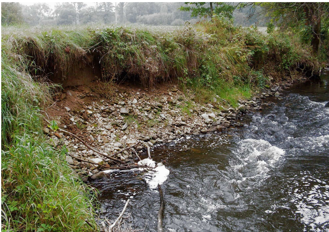
Obr. č. 19 Břehová nátrž v úseku BL026 (foto: V.Kaštánková)
