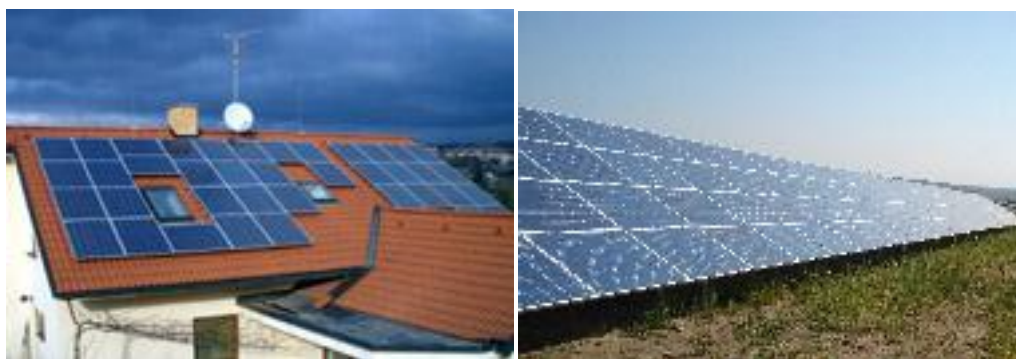
Obrázek č. 11 Síťový fotovoltaický systém
