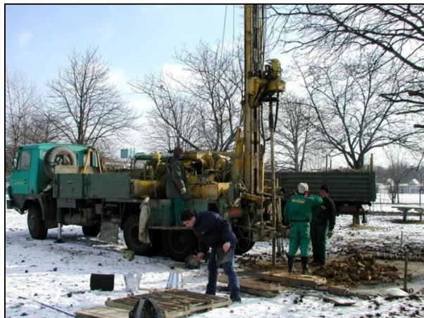
Obr. 2.5: GTP pro Královopolské tunely v Brně, realizace vrtných prací v prostředí zemin [17]
