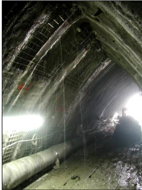
Obr. 1.5: Ražená průzkumná štola v rámci inženýrskogeologického průzkumu pro Královopolské tunely v Brně
