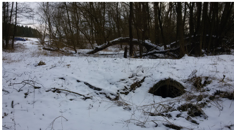
Obrázek 7.: Nefunkční propustek [vlastní]
