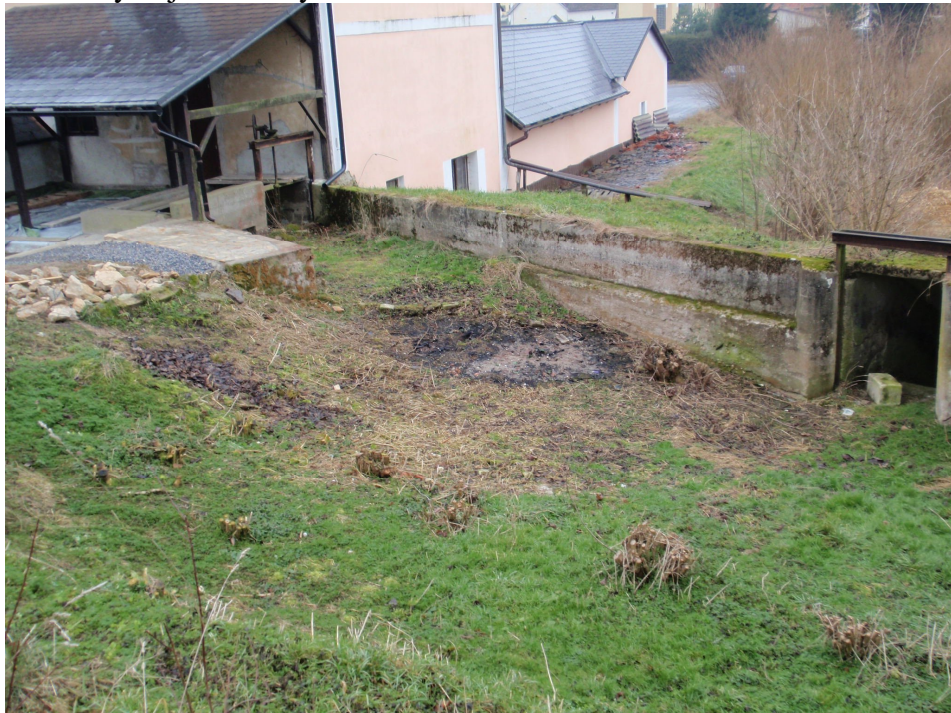
Obrázek 9.: Neudržovaný nátokový objekt do mlýna [vlastní]
