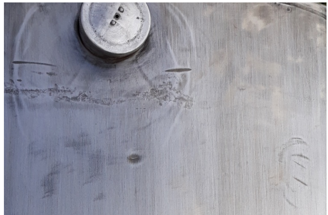
Obr. 67 Nerovnosti na povrchu nádrže po druhé fázi broušení
