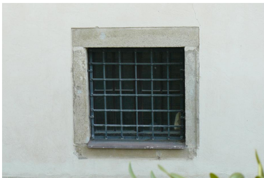
(b) Ostění okna v přízemí severního křídla zámku, foto: autorka.
