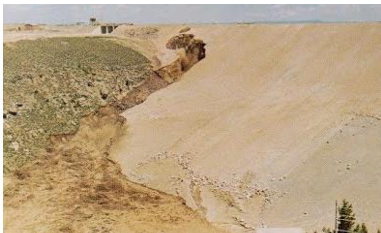
Obr. 16 Trhlina přehrady Teton [49]
