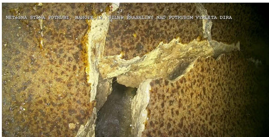
Obr. 37 – 37.02 m – Detail netěsností, silných prasklin a vymleté díry nad potrubím [BVK,a.s]
