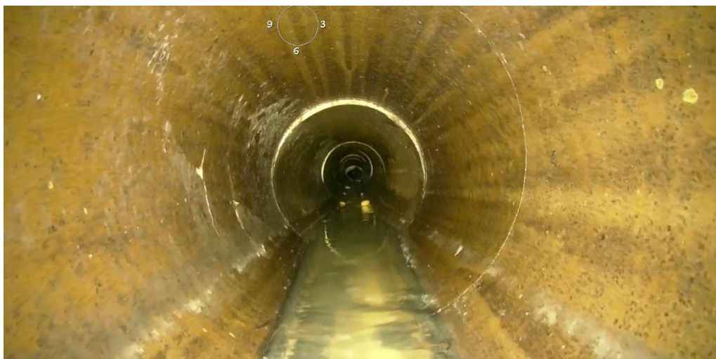
Obr. 32 – 28.64 m – Příčná prasklina [BVK, a.s.]
