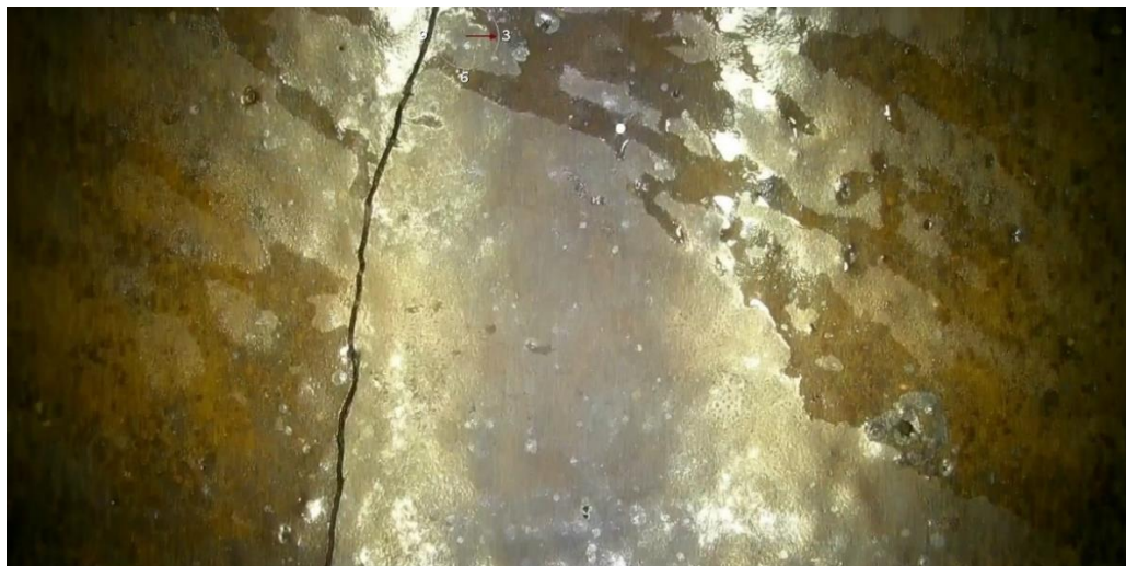
Obr. 33 - 28.64 m - Detail příčné praskliny [BVK, a.s.]
