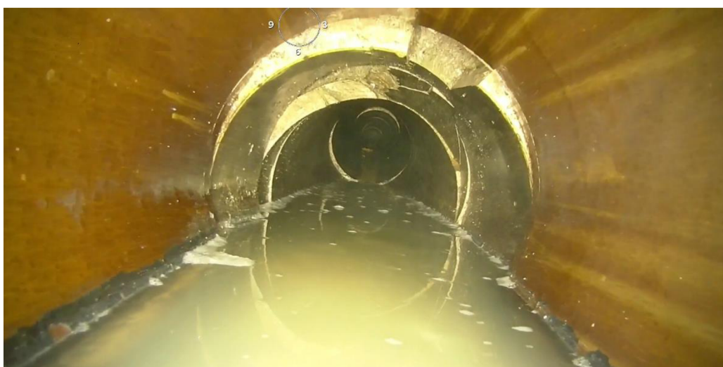
Obr. 34 – 36.91 m – Netěsná stěna potrubí, chybějící část stěny [BVK, a.s.]
