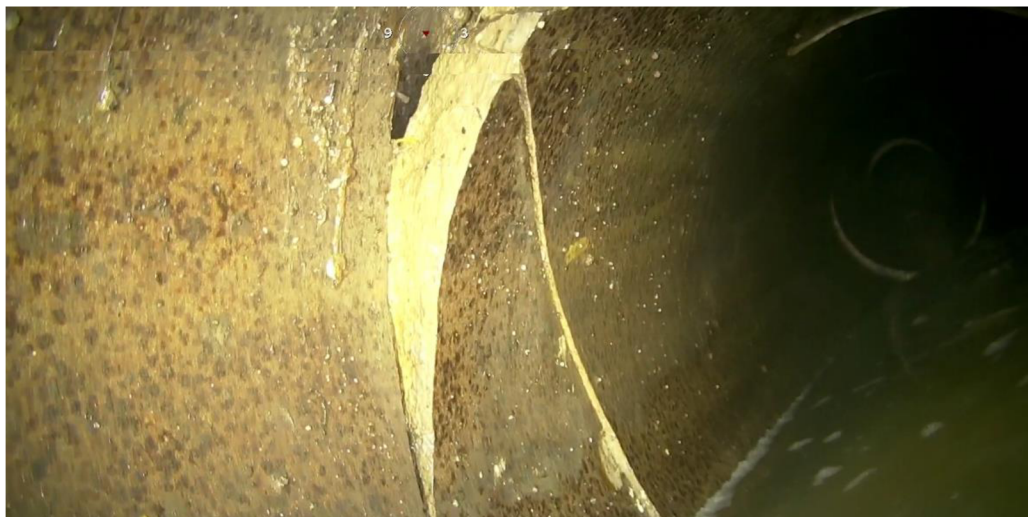
Obr. 36 – 37.02 m – Netěsná stěna potrubí, silné praskliny, vymletá díra [BVK, a.s.]
