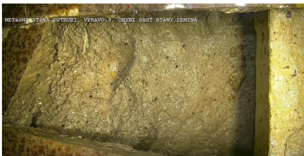
Obr. 35 – 36.91 m – Chybějící část stěny, je vidět zemina [BVK, a.s.]
