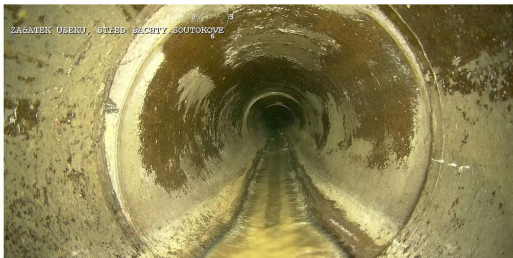
Obr. 27 - 0.00 m - Začátek úseku [BVK, a.s.]
