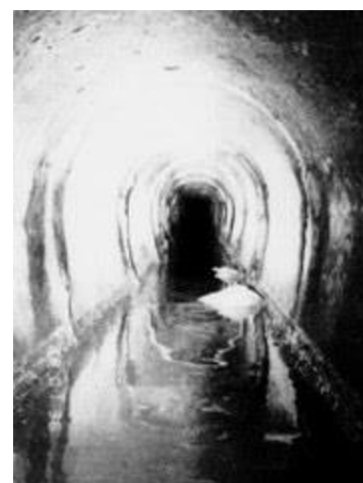
Obr. 19 Příklad hodnocení poškození konstrukce [26]
