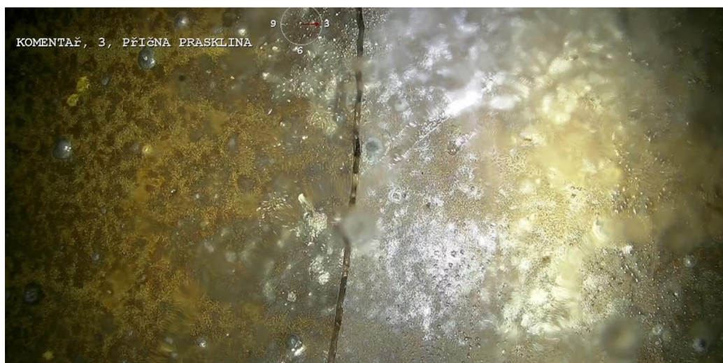
Obr. 39 – 40.28 m – Detail příčné praskliny [BVK, a.s.]
