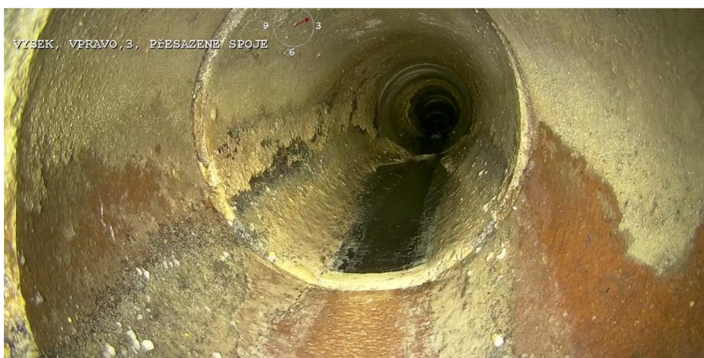
Obr. 31 - 22.40 m - Výšek vpravo, přesazené spoje [BVK, a.s.]
