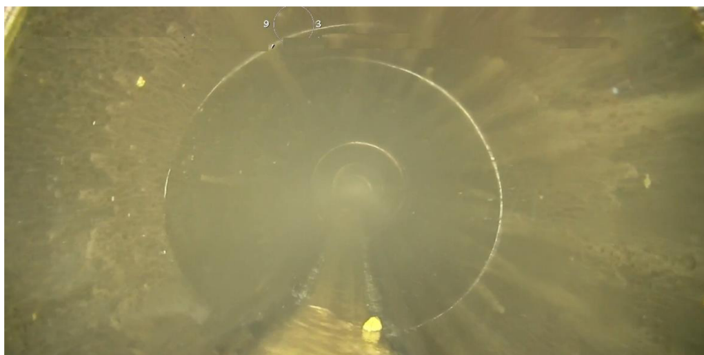
Obr. 38 – 40.28 m – Příčná prasklina [BVK, a.s.]
