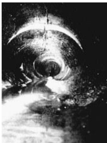
Obr. 17 Příklad hodnocení poškození konstrukce [26]
