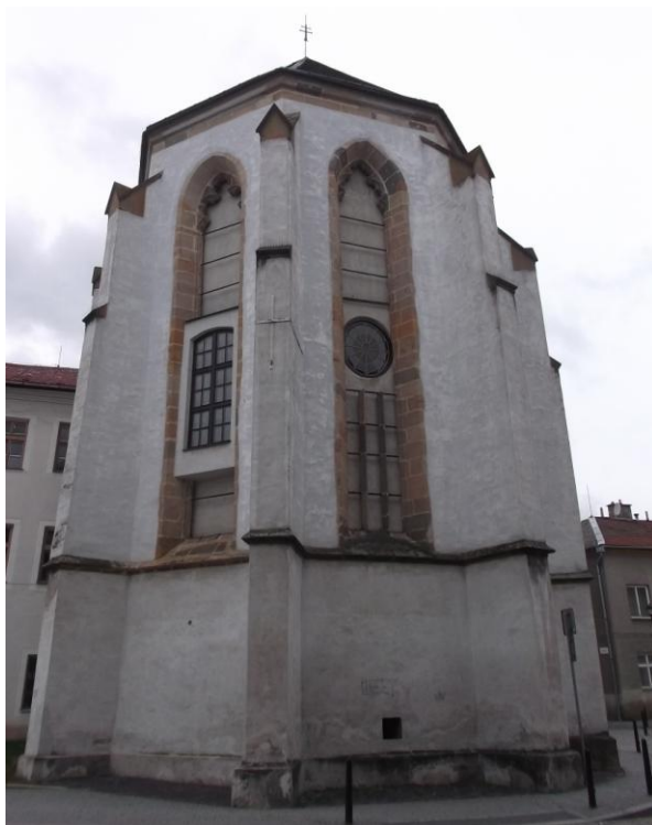
17. Uničov, bývalý kostel Povýšení sv. Kříže, pohled na východní stranu presbytáře se zazděnými gotickými okny s fragmenty kružeb ve vrcholech
