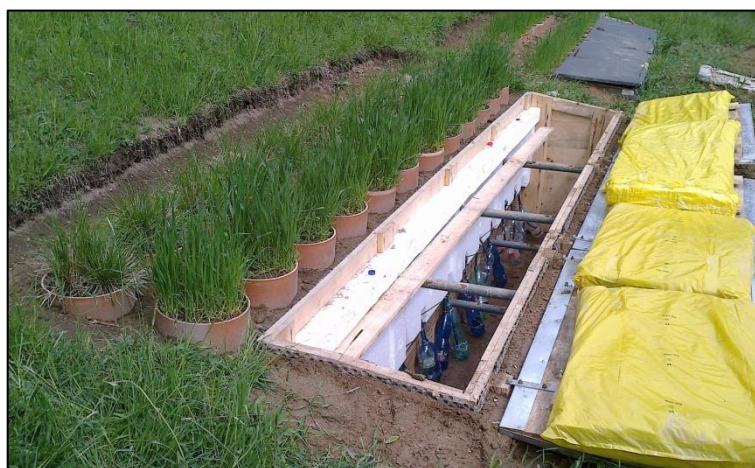
Obr. 23: Přístupová šachta k lyzimetřům s nádobami pro odběr perkolátů (zdroj: autor).
