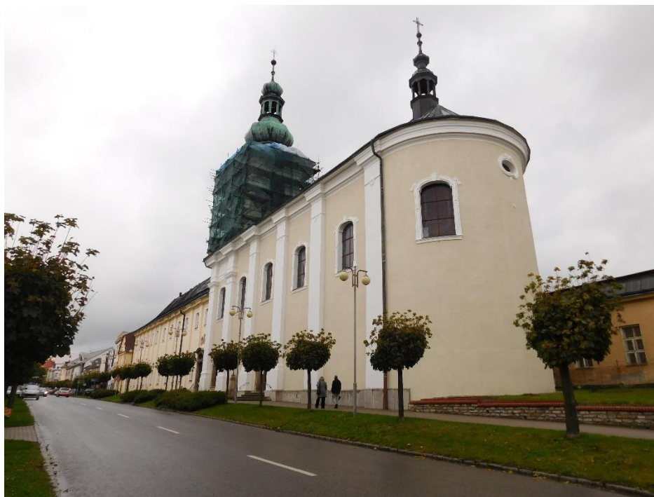
77. Nové Město nad Metují, klášter milosrdných bratří s kostelem Narození Panny Marie, 1693–1769, průčelí.
