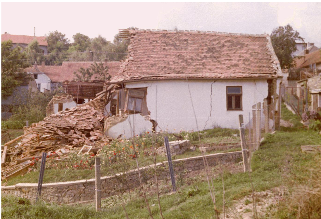
Obr. 6 Destrukce obytného domu svahovým pohybem v Budkovicích-Svízle (foto - A. Paseka)
