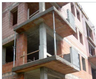
rohový balkón s přidanou výztuží
