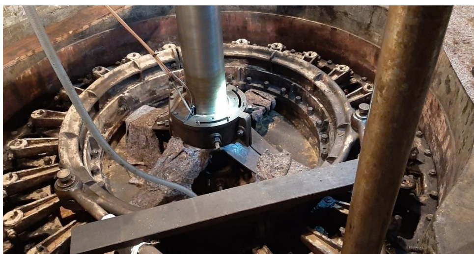
Obr. 11 Pohled na turbínu s rozváděcím kruhem
