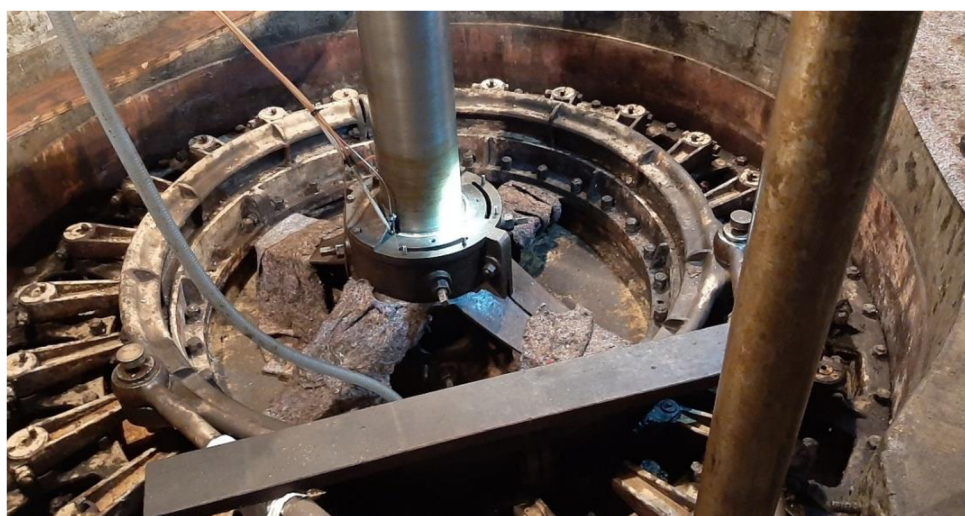
Obr. 11 Pohled na turbínu s rozváděcím kruhem
