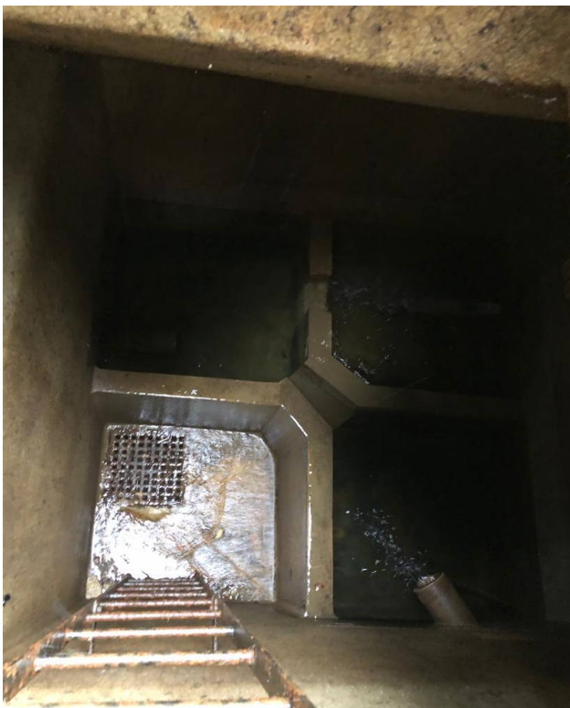
Obr. 26: Oloví, sběrná šachta (vlastní, 2020).
