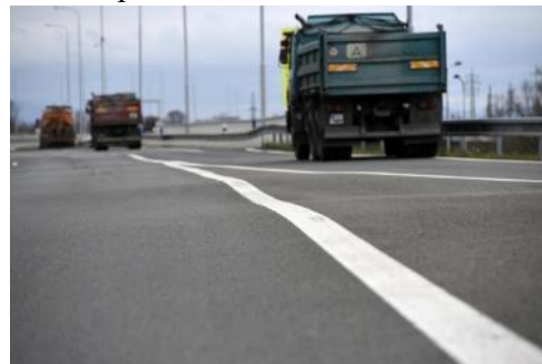
Obrázek U 75: Zvlnění dálnice D1 v Ostravě
