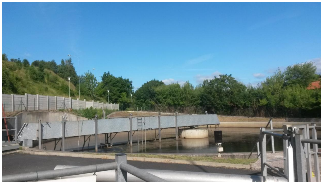
Obrázek 12 - Dosazovací nádrž s pojezdovým mostem
