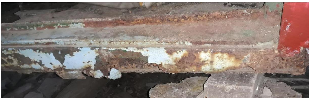
Obr. 90 Zbytek prahu a nosník prahu poškozený korozí
