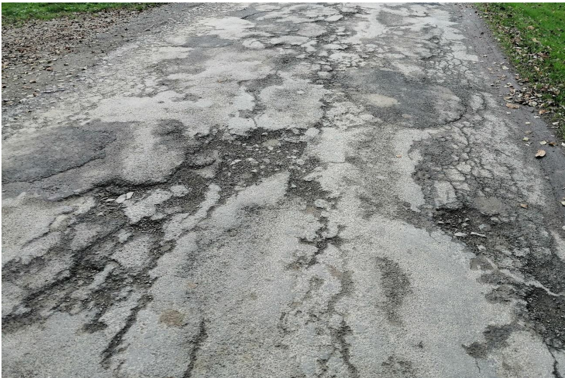
Obrázek 15: Výtluky vzniklé z hlubkové koroze
