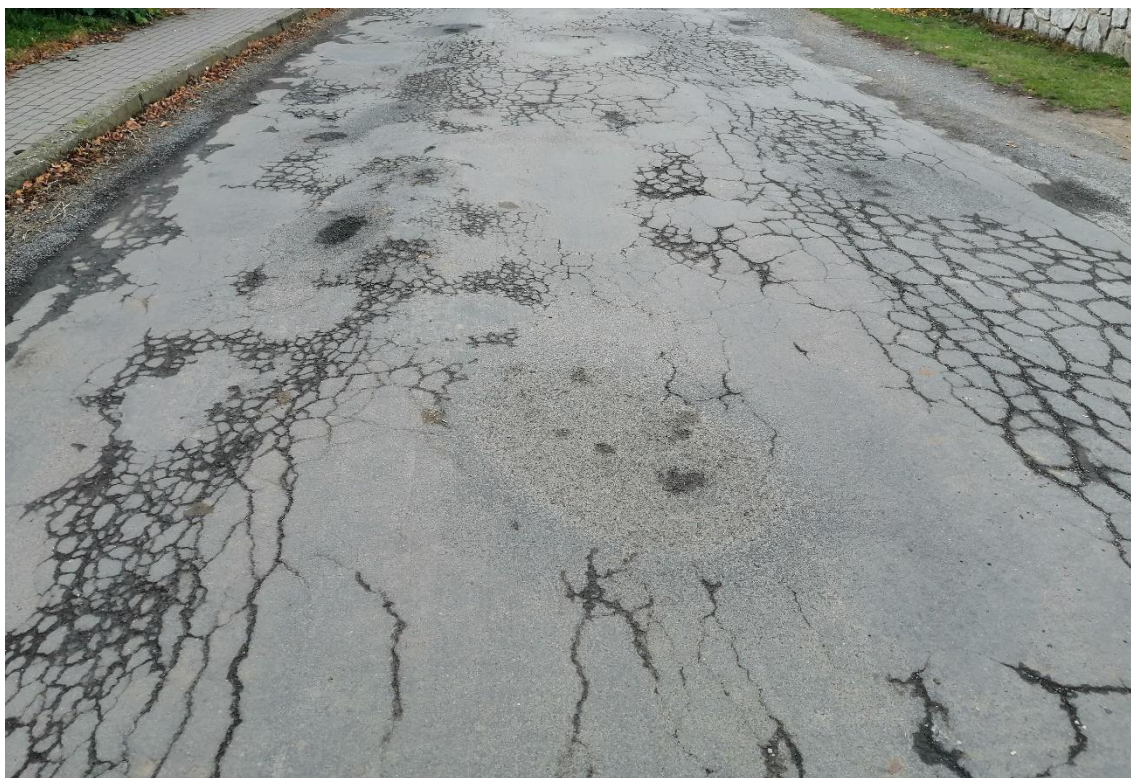
Obrázek 12: Síťové trhliny v pozdním stádiu vývoje
