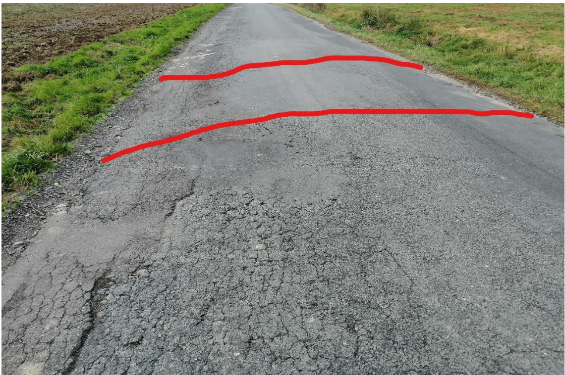
Obrázek 13: Plošná deformace vozovky
