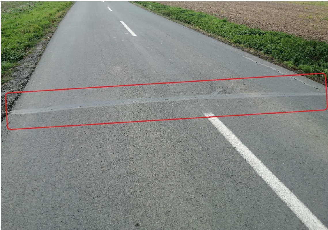
Obrázek 16: Trhlina příčná úzká mrazová
