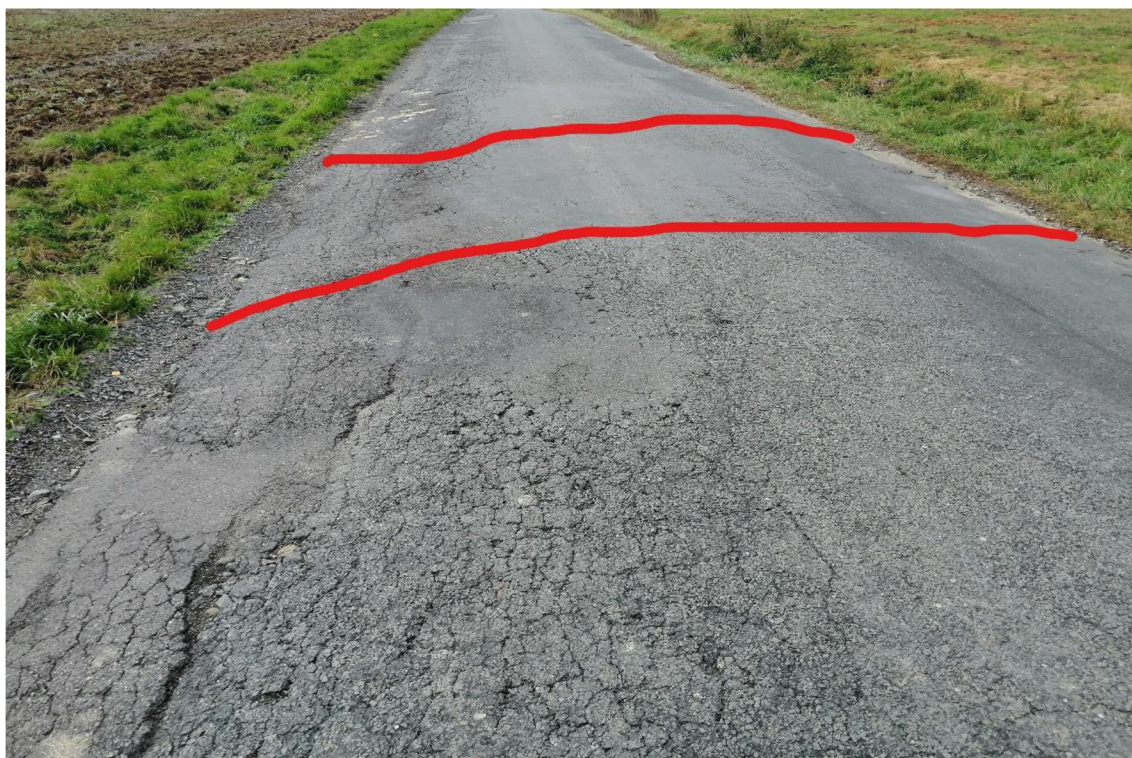
Obrázek 13: Plošná deformace vozovky
