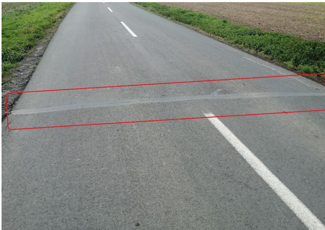
Obrázek 16: Trhlina příčná úzká mrazová
