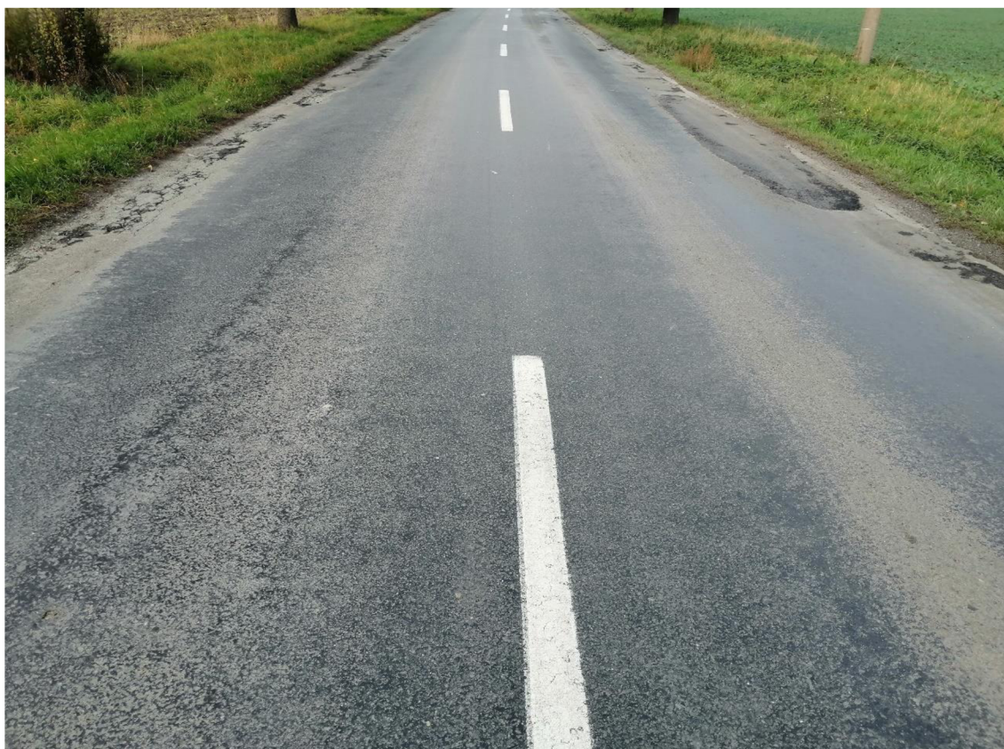
Obrázek 17: Ztráta makrotextury – celoplošné pocení povrchu
