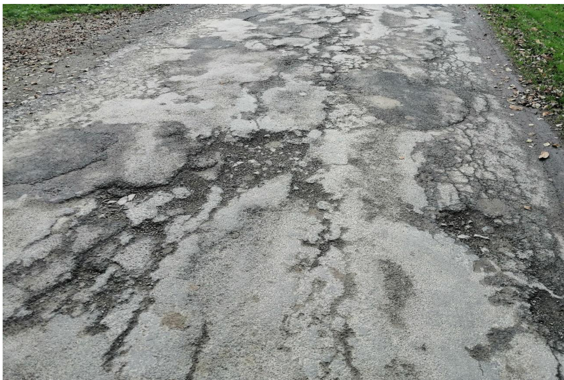
Obrázek 15: Výtluky vzniklé z hlubkové koroze
