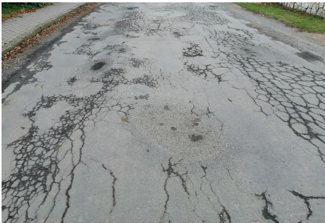
Obrázek 12: Síťové trhliny v pozdním stádiu vývoje
