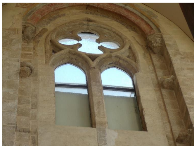
122. Jihlava, dominikánský kostel sv. Kříže, detail severního závěrového okna presbytáře, polovina 13. století
