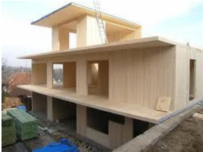
Obr. č. 13 Konstrukce z masivního dřeva – rozestavěná budova z masivních desek (bydleni.idnes.cz)
