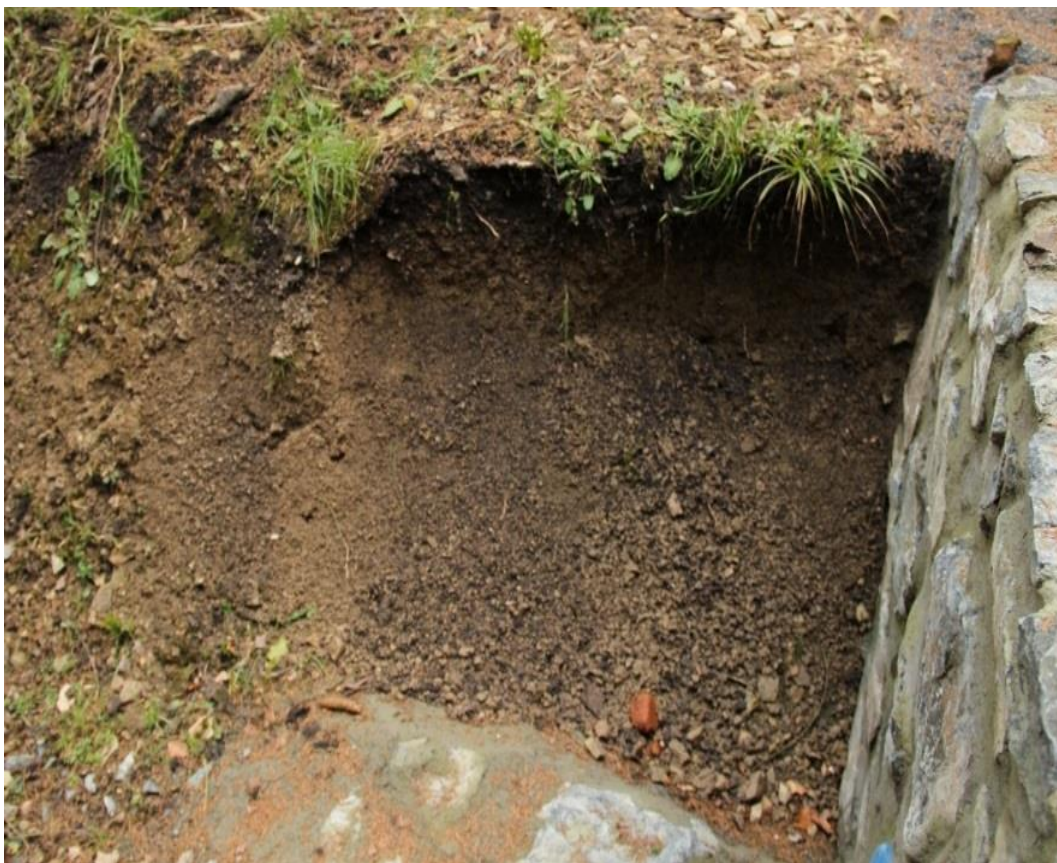
Obrázek 7: Ukázka erodovaného povrchu u propustku
