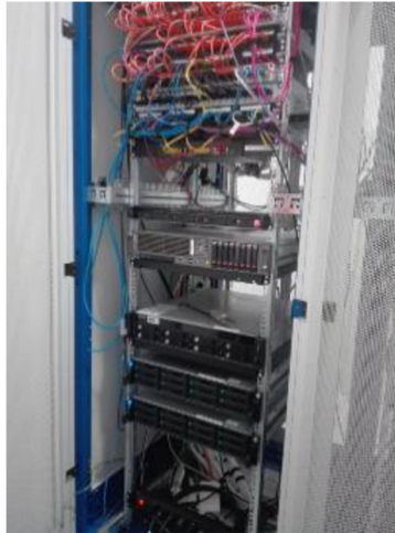
Obrázek č. 10: Fotka hlavního racku v serverovně (Zdroj: Vlastní zpracování)
