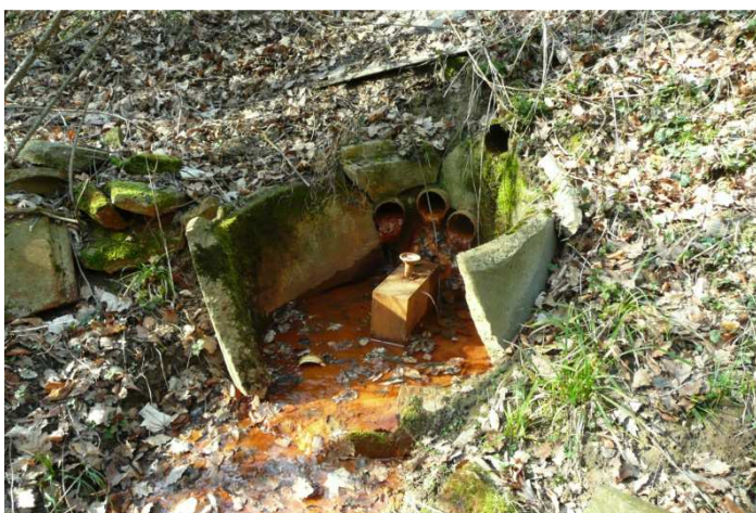
Obr. 11: Vyústění vodorovných odvodňovacích vrtů do studny poškozené dalším sesuvem.
