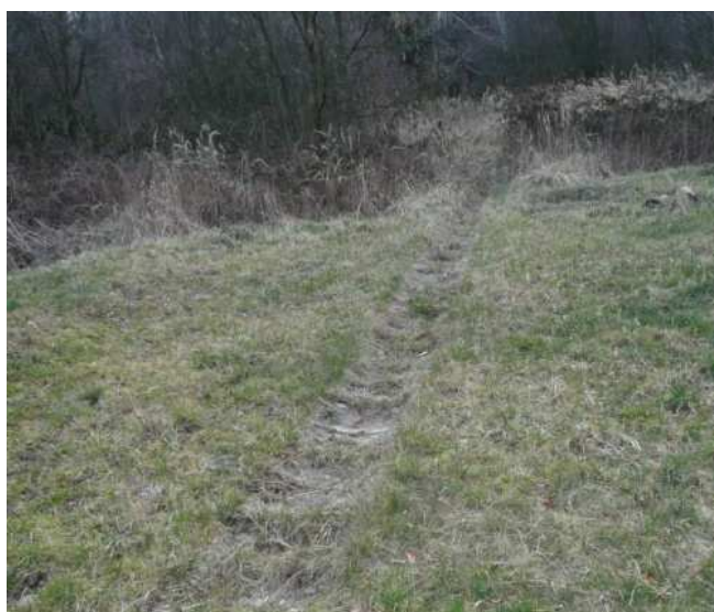
Obr. 10: Neudržované odvodňovací žebro
