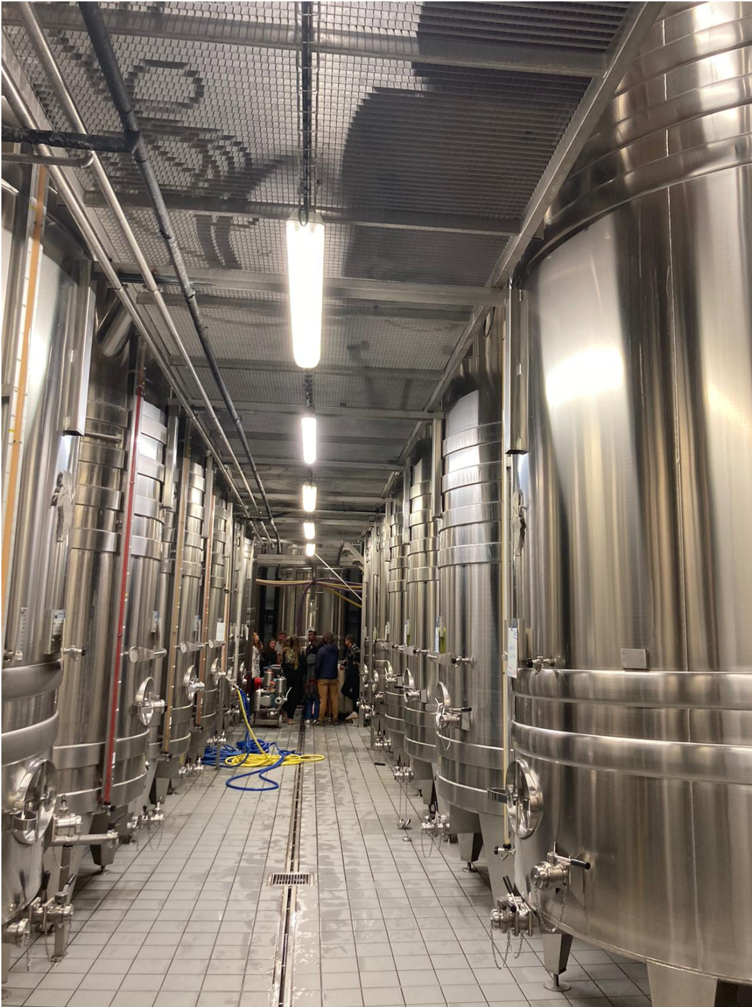
Příloha 5: Cuverie – nádrže z nerezové oceli umístěné v budově družstva s řízenou teplotou, ve kterých je uskladněna šťáva z hroznů. Probíhá zde proces první fermentace a ze šťávy se díky kvasinkám stává víno.
