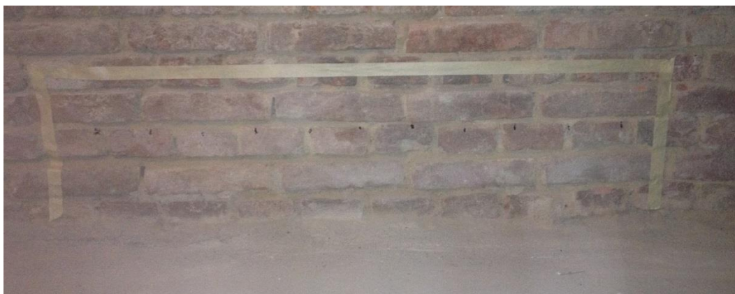
Obr. 78: Část zdi ve sklepních prostorách budovy D v areálu FAST VUT v Brně
