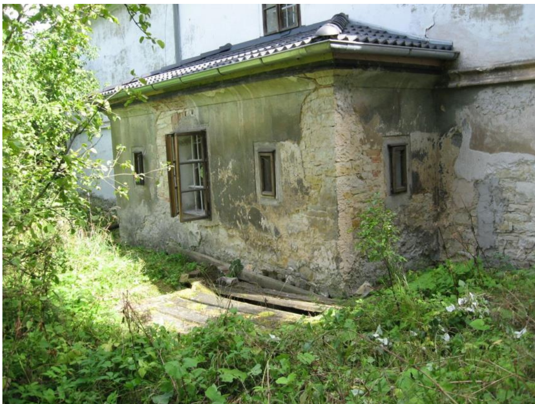
Obr. 8: Následek působení vlhkosti na přízemní část zděné konstrukce[8]
