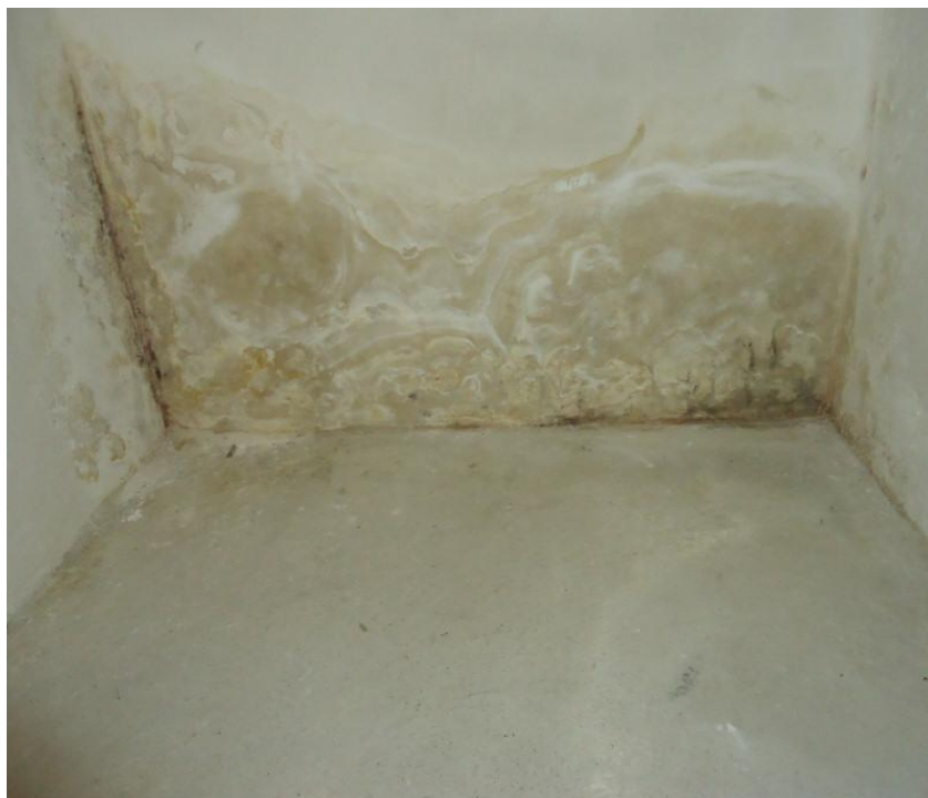
Obr. 4.7 Vznik plísní vlivem průsaků vody špatně izolovanou stěnou [21]
