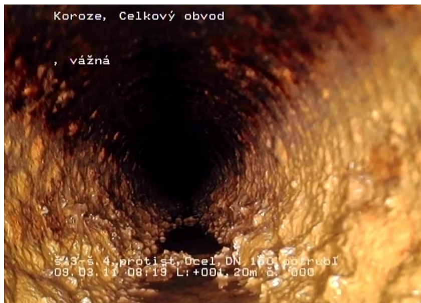
Obr. 4.9 Ocelové potrubí s velmi silnou korozi [24]
