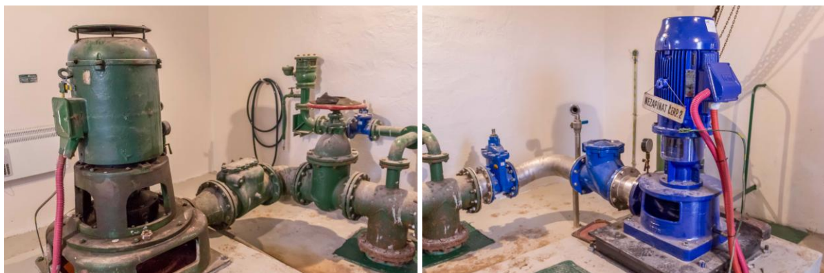
Obr. 5.4 Snímek stávajícího soustrojí starého (vlevo) a nového (vpravo) čerpadla
