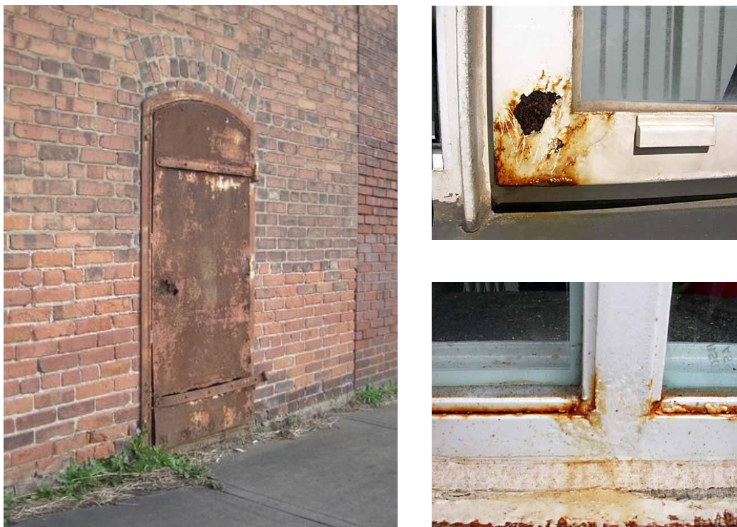
Obr. 4.3 Příklady silné koroze kovových dveří (vlevo) a silné koroze okenního rámu (vpravo) [17] [18]
