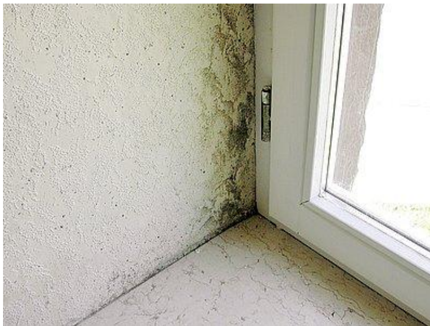
Obr. 4.6 Vznik plísní vlivem netěsnosti okenního rámu [20]
