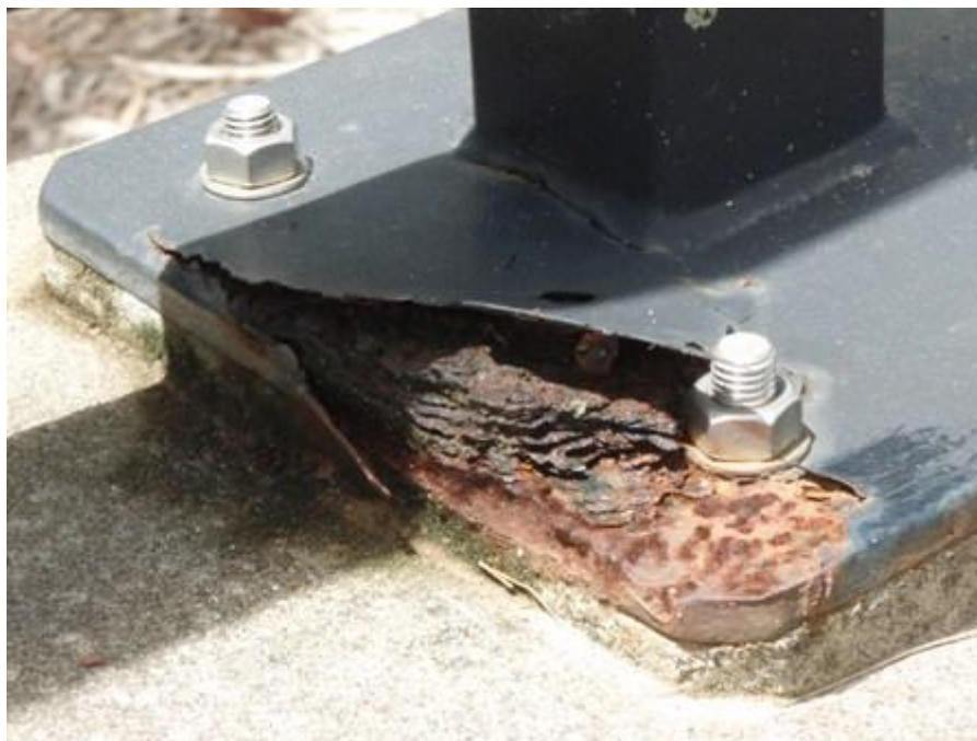
Obr. 4.5 Koroze kotvící části u kovového zábradlí [44]
