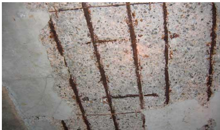
Obr. 4.4 Vydrolování (koroze) betonu stropní konstrukce a obnažení výztuže [19]
