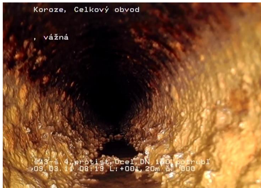
Obr. 4.9 Ocelové potrubí s velmi silnou korozi [24]
