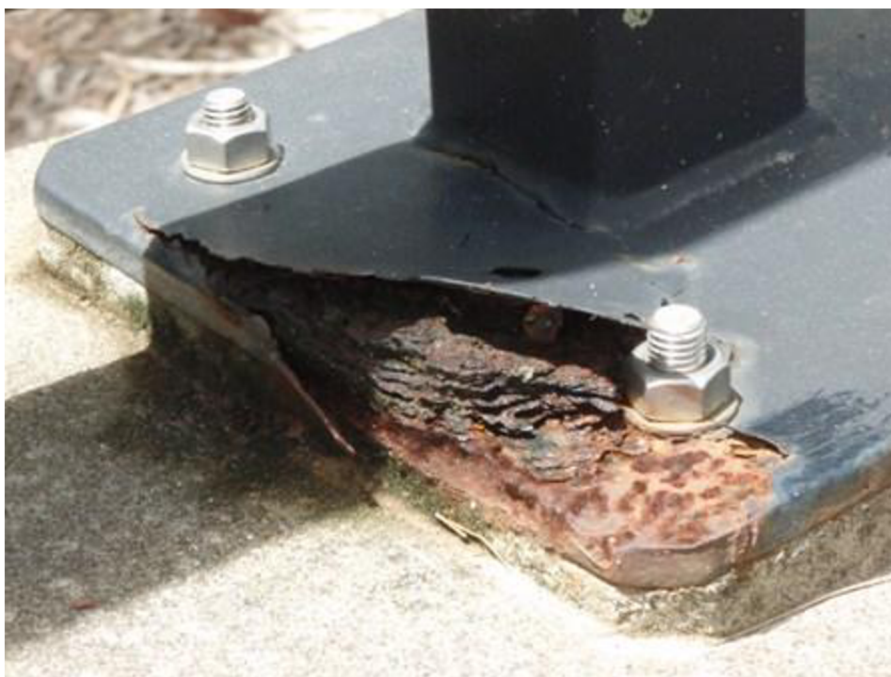
Obr. 4.5 Koroze kotvící části u kovového zábradlí [44]
