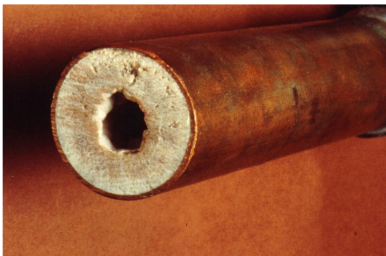
Obr. 4.10 Příklad zarůstání potrubí vápencem způsobeného nadměrnou tvrdostí vody [25]
