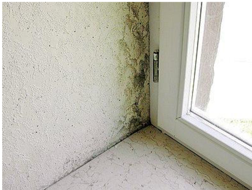
Obr. 4.6 Vznik plísní vlivem netěsnosti okenního rámu [20]
