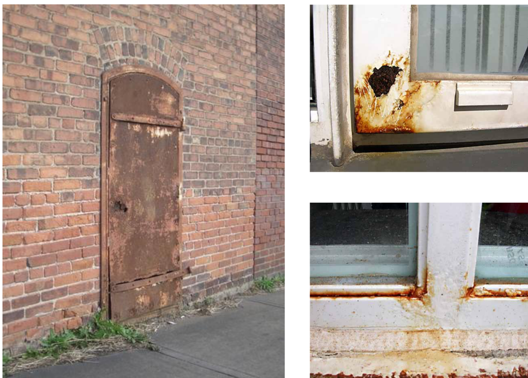
Obr. 4.3 Příklad silné koroze kovových dveří (vlevo) a silné koroze okenního rámu (vpravo) [17] [18]
